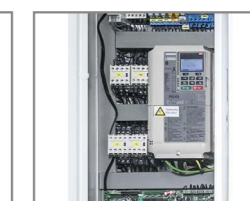
Quadro di manovra Impianto Mrl
