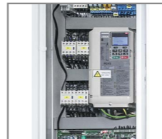
Quadro di manovra Impianto Mr1
