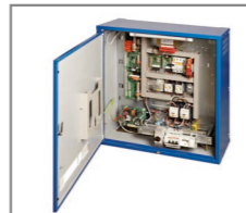
Quadro di manovra Impianto oleodinamico
